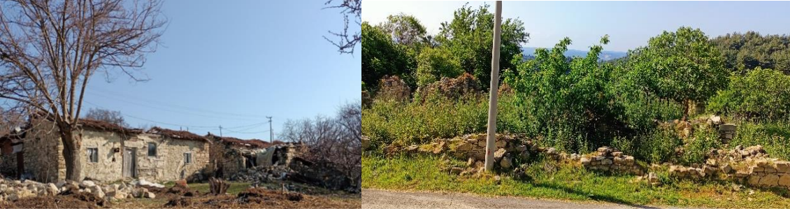
Fotoğraf 4. Köy içinde yıkıntı durumundaki yerel mimari örnekleri (2023)
